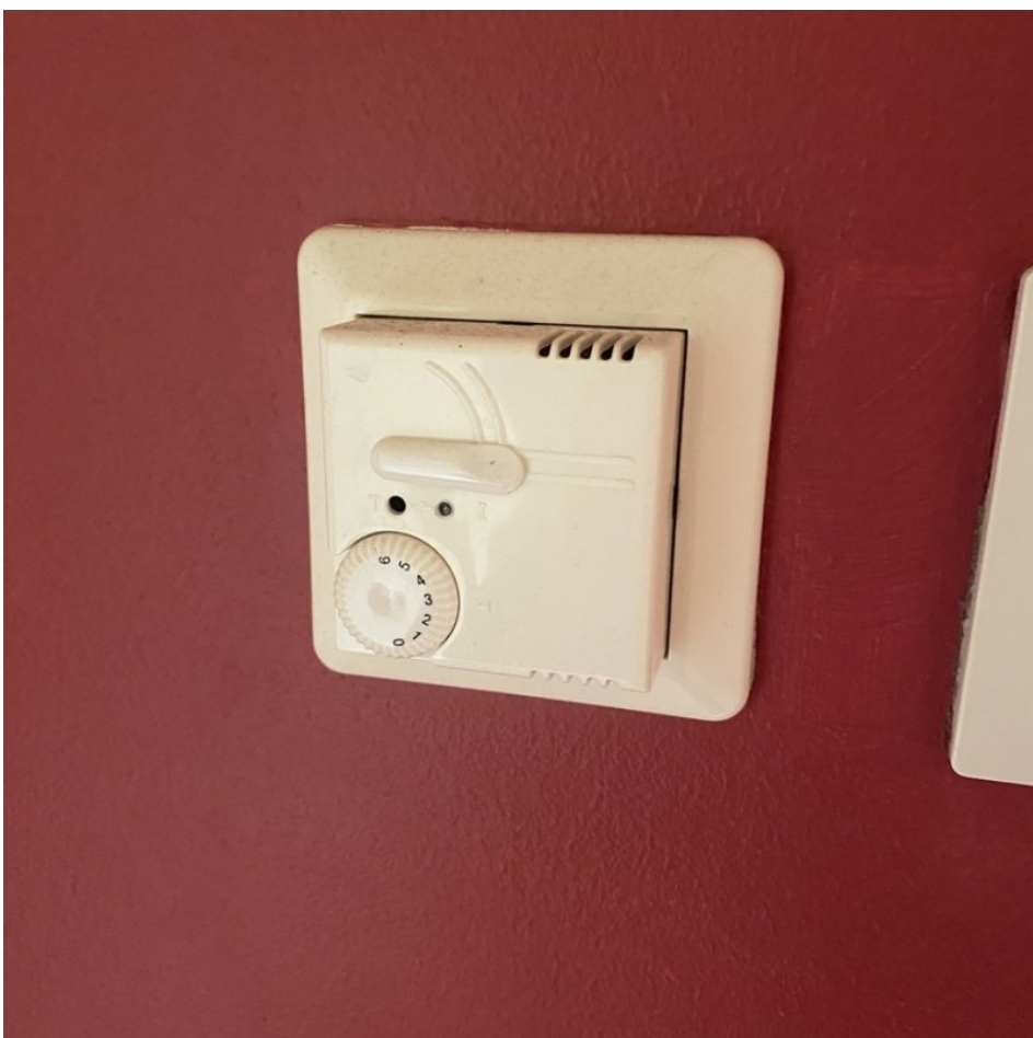
5. Yleiskuva: Pesuhuoneen ja saunan lattialämmitystä säädetään pesuhuoneen oven vieressä sijaitsevasta termostaatista.
