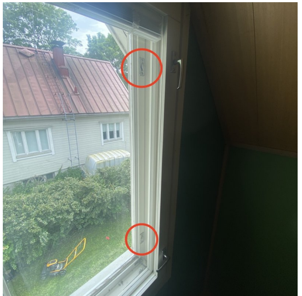
8. Yläkerran asuinhuoneiden ulommista ikkunoista puuttuu kiintokahvat (sisäikkunoihin asennettu). Häätätilanteessa ikkuna tulee saada nopeasti auki sitä rikkomatta. Suositellaan kiintokahvojen asentamista myös yläkerran asuinhuoneiden ulompiin ikkunoihin turvallisuuden varmistamiseksi.
