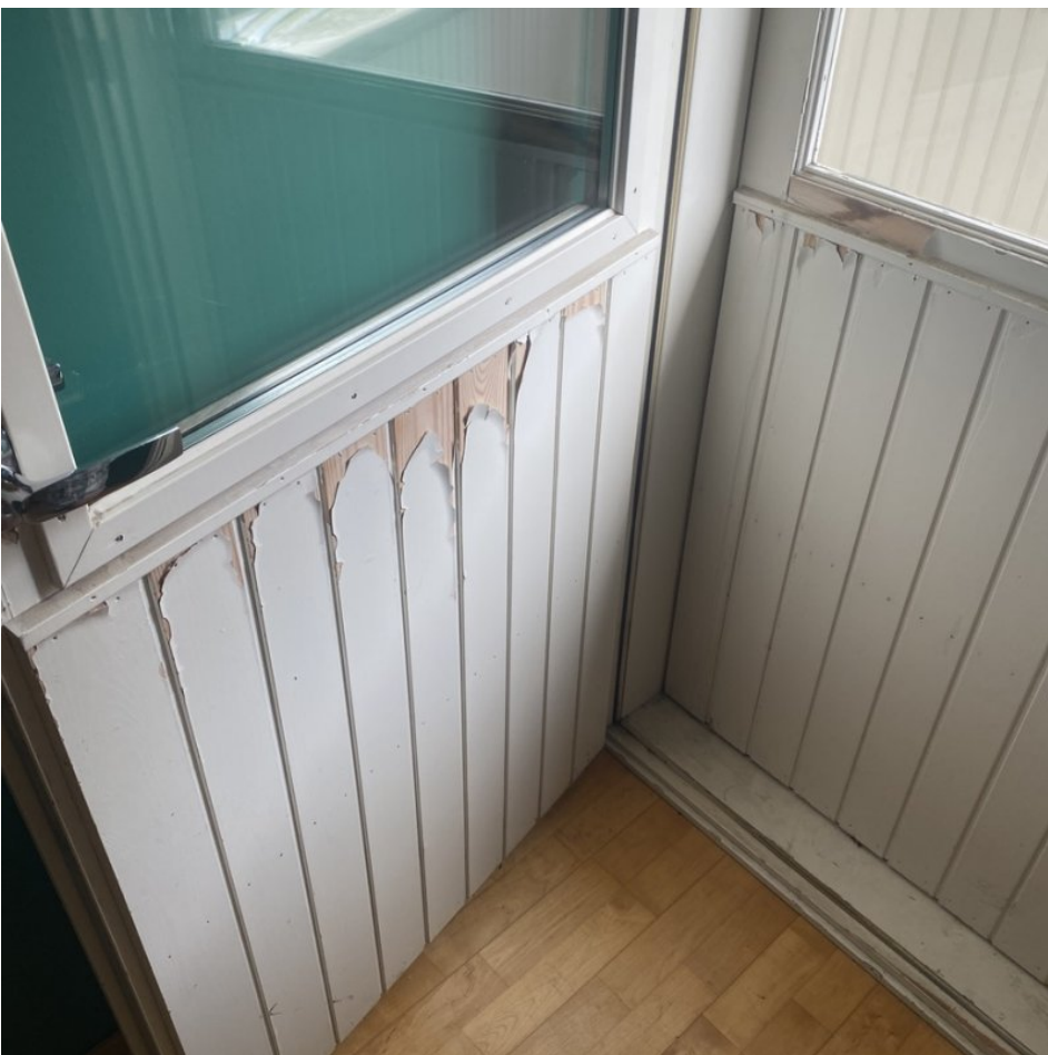
7. Parvekkeen ulko-oven maalipinta on kulunut/vaurioitunut.
