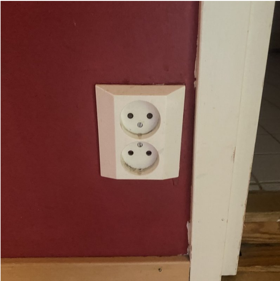
3. Huomio: Sähköjärjestelmä on pääosin alkuperäinen(maadoittamaton). Sähköjärjestelmän osien tekninen käyttöikä on pääosin noin 30-50 vuotta (ST 97.00, Sähkö- ja tietojärjestelmienkuntotutkimus, 2005).
