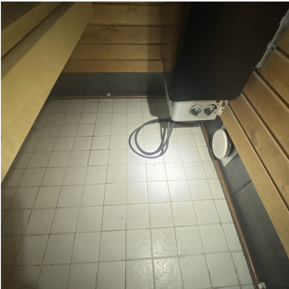
7. Yleiskuva: Saunassa ei ole erillistä lattia-/kuivakaivoa vaan lattian vedenpoisto perustuu lattian kaatoihin kohti pesuhuoneen lattiakaivoa. Arvion perusteella kaadot ovat osin niukat ja vesi voi jäädä viipyilemään kiukaan alueelle. Lattian kuivaaminen käytön jälkeen säännöllisesti lastalla vähentää lattian pintakosteutta.
