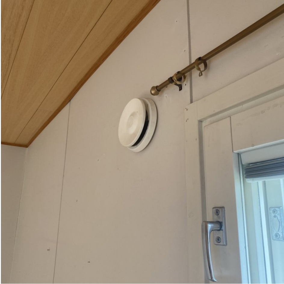
2. Yleiskuva: Asuinhuoneisiin on asennettu ohjeiden mukaiset korvausilmakanavat.
