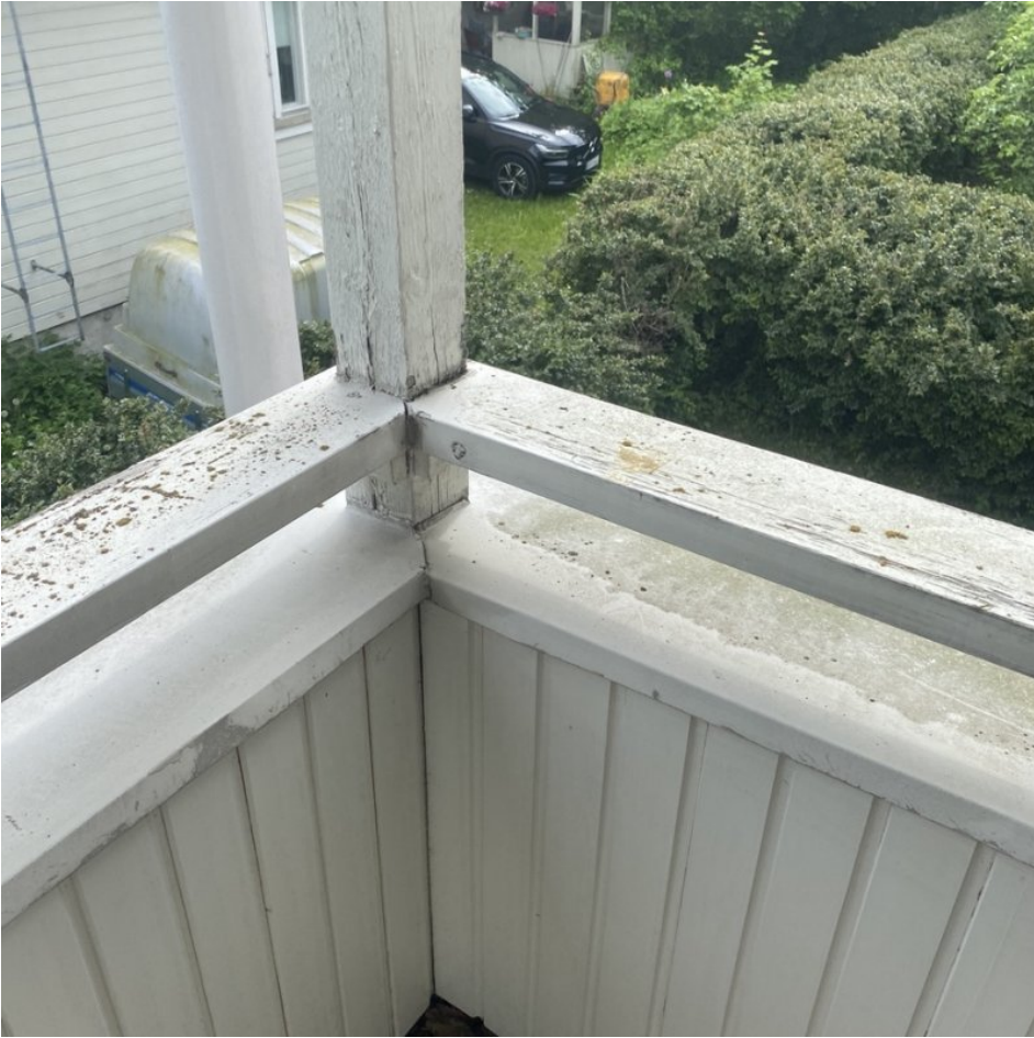
5. Parvekkeen puuosien maalipinta on kulunut. Pinnoite suojaa ja edesauttaa puuosien kestävyyttä. Suositellaan parvekkeen puuosien huoltomaalausta niiden kestävyysvarmistamiseksi.
