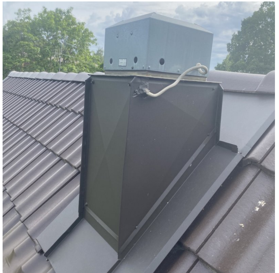
5. Yleiskuva: Asunnon koneellinen poistoilmanvaihto on järjestetty huippumurilla. Nykyinen imuri on asennettu saatujen tietojen mukaan 2010-luvun puolella välissä. Jatkuvasti käytössä olevien huippumurien tekniseksi käyttöiäksi on määritetty 10-15 vuotta (lähde: RT 18-10922).
