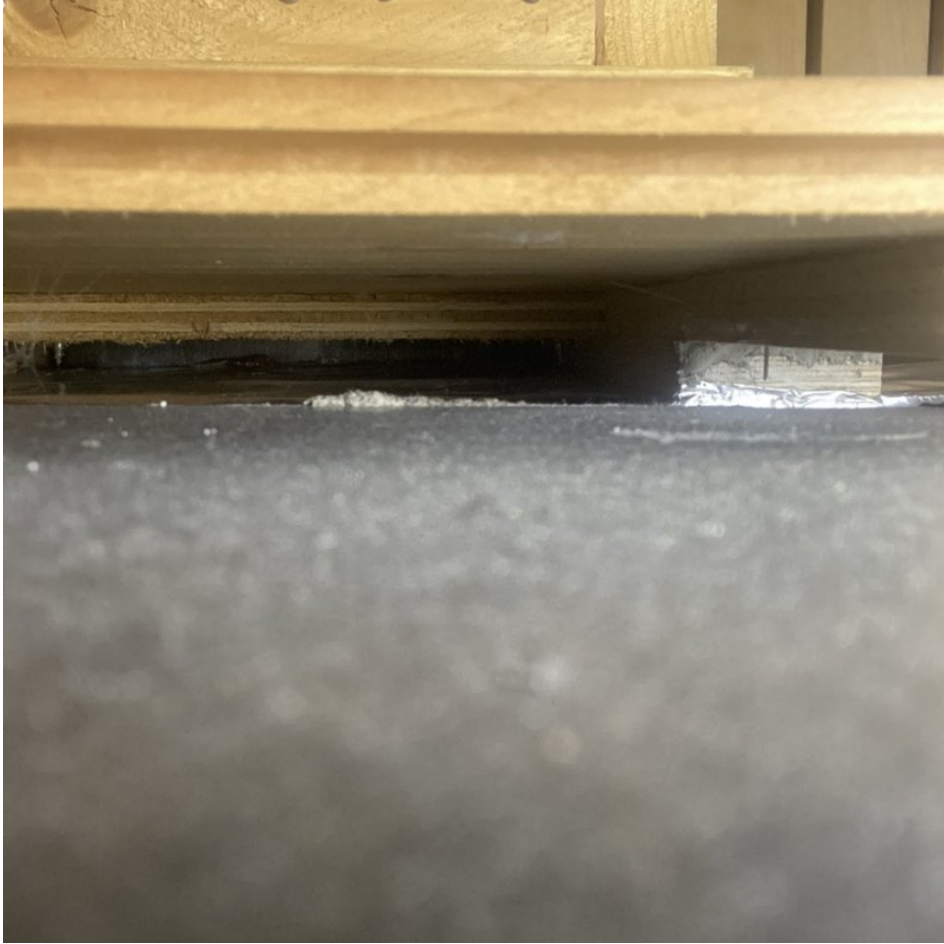
5. Yleiskuva: Saunan paneeliseinän takaa havaittiin tuuletusrako.
