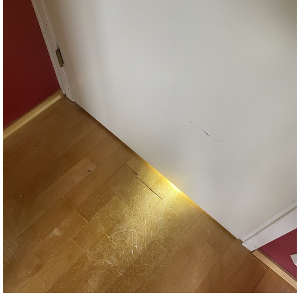
3. Yleiskuva: Väliovien siirtoilmareittien toiminnassa ei havaittu puutteita tarkastetuilta osin. Toimivan ilmanvaihdon kannalta on tärkeää, että ilma pääsee esteettä liikkuman huoneiden välillä myös ovien ollessa kiinni.
