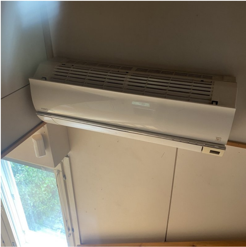
3. Yleiskuva ilmalämpöpumpun sisäyksiköstä.
