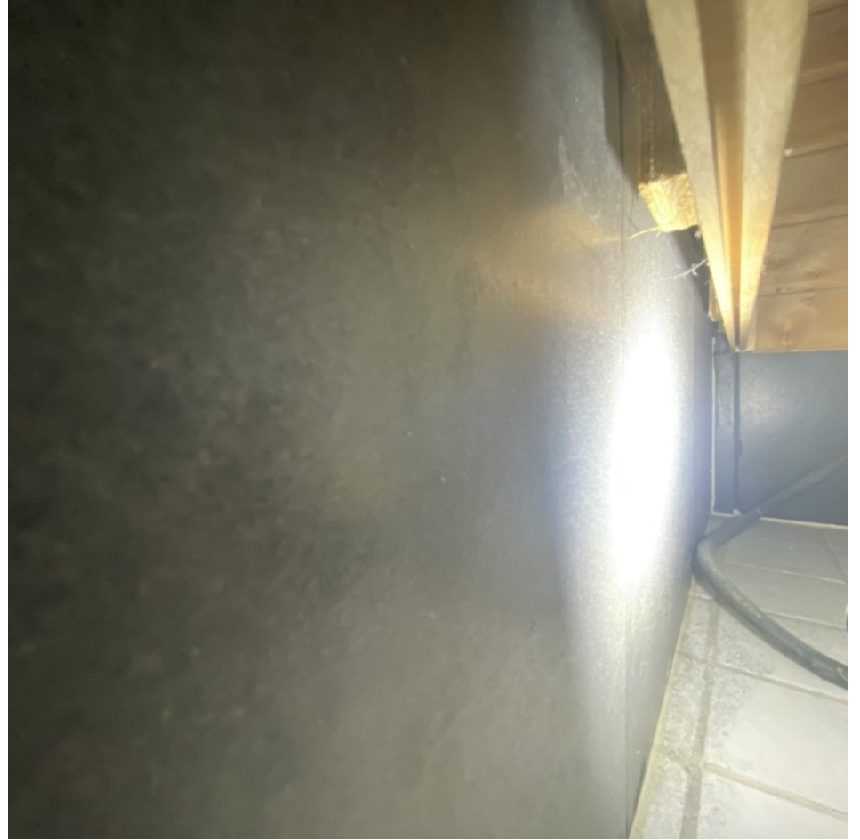
6. Tarkastusta rajoittava tekijä: Saunan höyrynsulun liityntää lattian vesieristeeseen/ laatoitukseen ei voitu tarkastaa luotettavastirakenteita rikkomattomin menetelmin (ei näköyhteyttä höyrynsulkuun).
