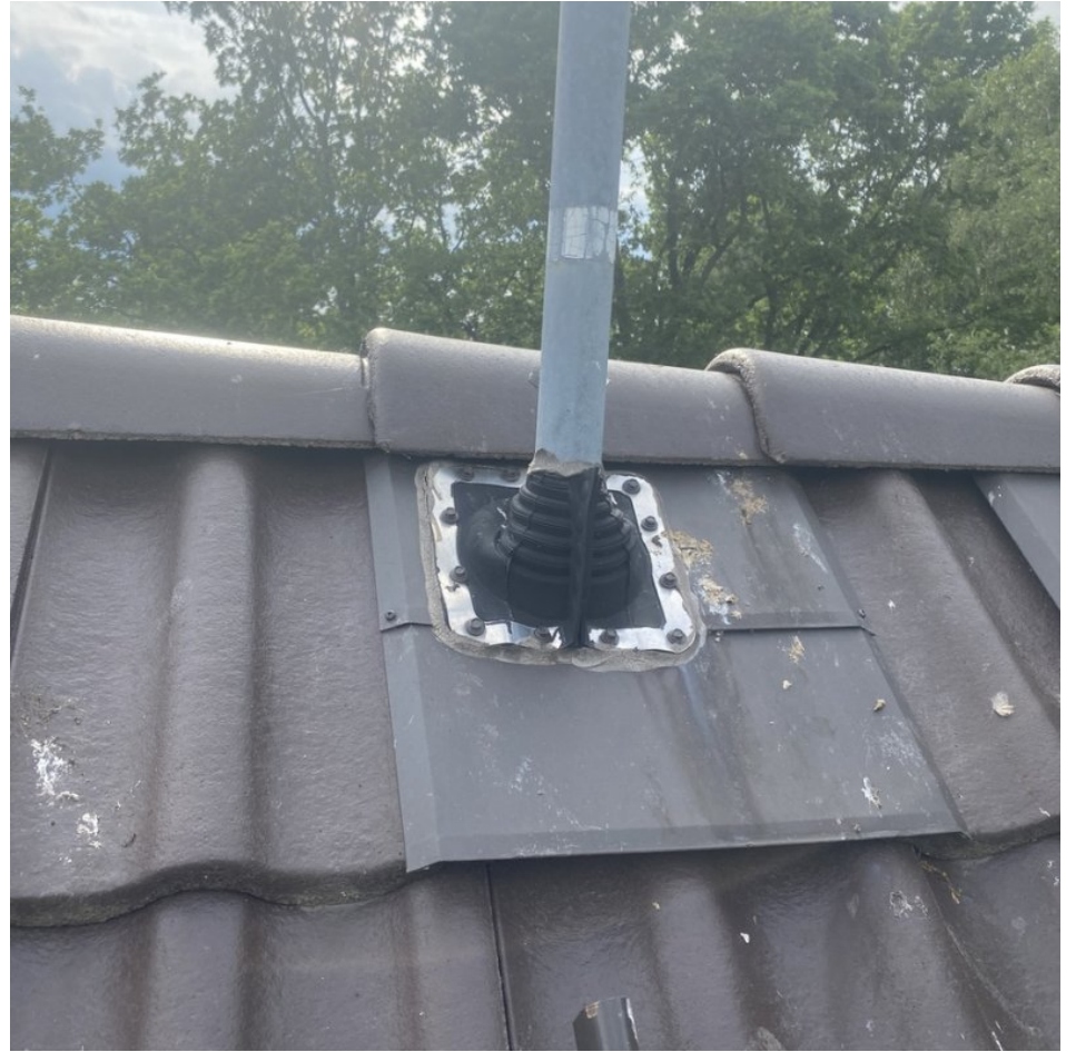
8. Yleiskuva: Antenniputken läpiviennin tiiveydessä ei havaittu puutteita. Antenniputken alapään tiivisteeseen vesitiiviys tulee varmistaa säännöllisellä huollolla. Tiivistemassat kuluvat ajan myötä, jonka vuoksi läpiviennin tiiviys tulee varmistaa säännöllisin väliajoin.
