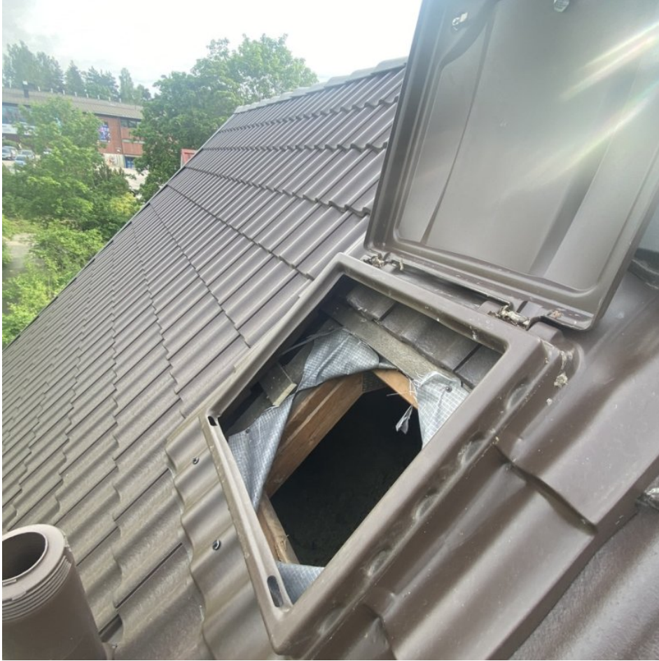
3. Yleiskuva: Yläpohjaan on järjestetty kulku vesikatolle asennetun kulkuluukun kautta. Huom. Luukun ja vesikaton huoltotien välissä ei ole erillistä tasoa, jonka vuoksi luukulle kulkeminen voi aiheuttaa turvallisuusriskin (etäisyys).
