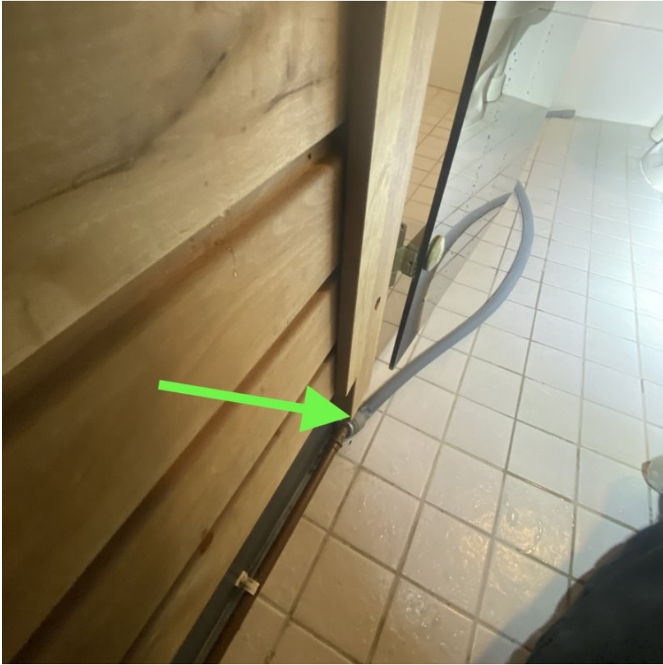
7. Yleiskuva: Lämminvesivaraajan ylivuotovedet on johdettu hallitusti suoraan viemäriin (pesuhuoneen lattiakaivolle).
