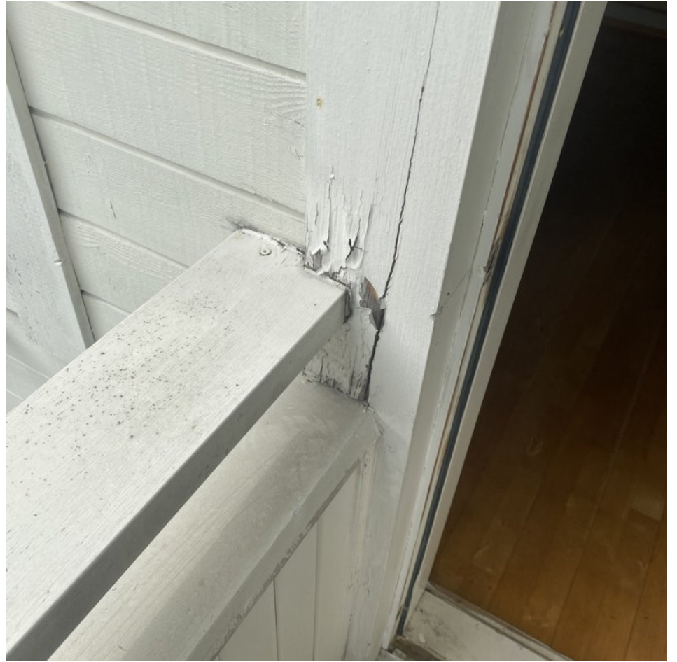
6. Parvekkeen puuosien maalipinnan kulumaa.
