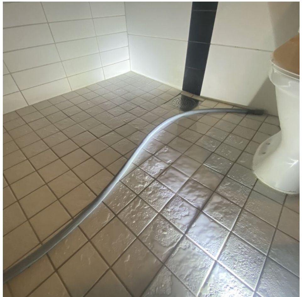
8. Yleiskuva: Pesuhuoneen lattian kaato testattiin vesikokeella (suihku päällä). Veden havaittiin paikoin viipyilevän lattialla ja kaivon läheisyydessä. Lattian kuivaaminen lattialastalla suihkun käytön jälkeen vähentää merkittävästi lattian pintakosteutta.
